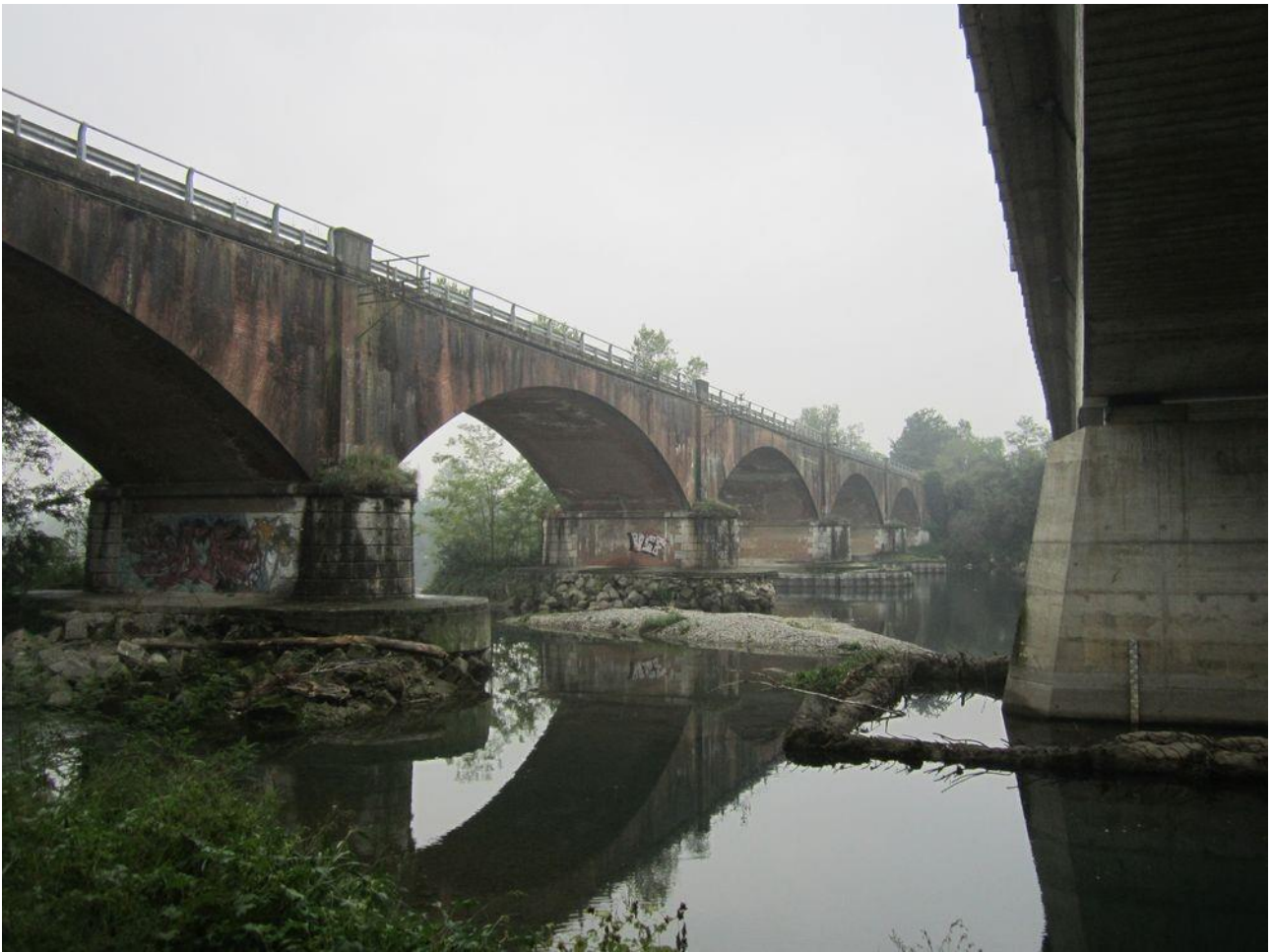
situazione attuale tra il ponte stradale della SP ex SS 415 e il ponte Asburgico
